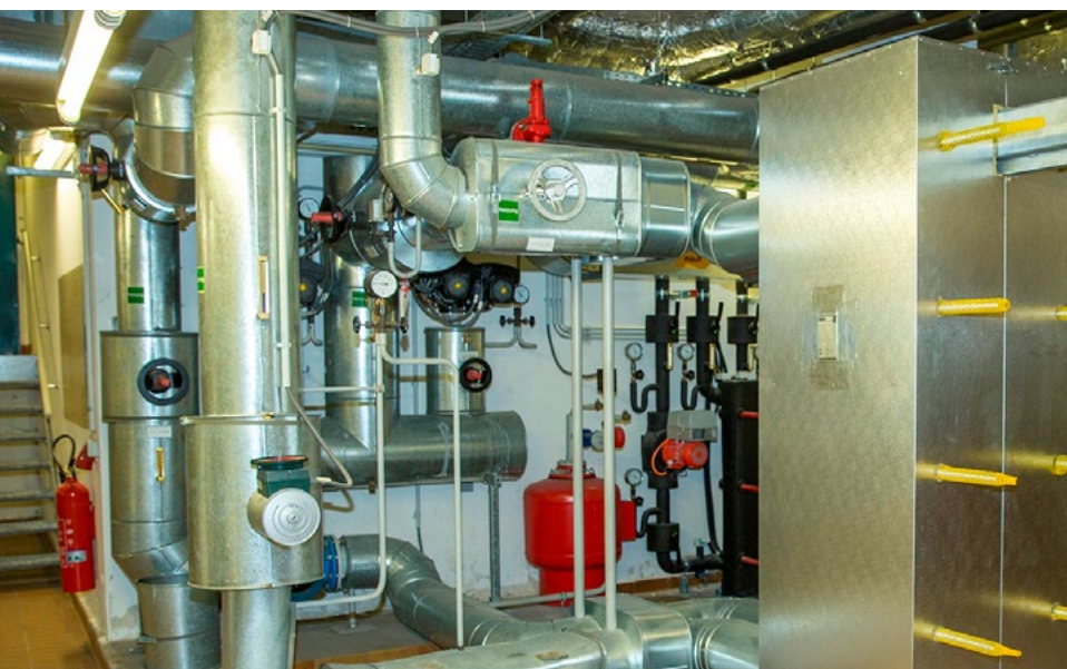
Wärmetauscher der Heizung am Standort Hamburg
